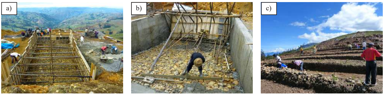
Figura 14. Proceso de construcción del sistema de biorremediación del C.U. Shallap-Huapish-Toclla: (a, b) sedimentadores y (c) humedales, setiembre-noviembre 2016. Fotos: A. Zimmer.
